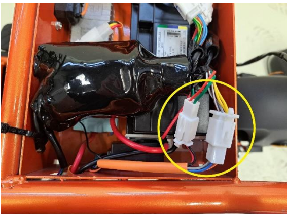
Avaa hälytin/ kaukokäytön liittimet.
